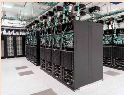
Tecnopolo di Bologna, Data center del Centro Mete Europeo Ecmwf - Riproduzione riservata, copyright Regione Emilia-Romagna
